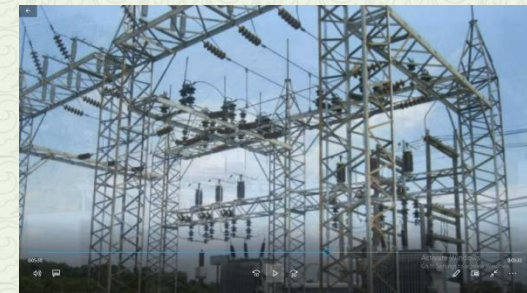
瑞道天然气电力站
